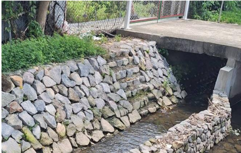
圖 11 級深不足的階梯
