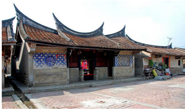
圖 5-2 修繕前的祠堂
