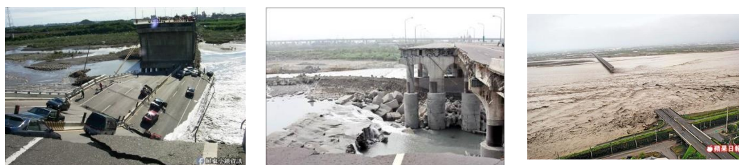
圖 1-1 歷年橋梁基礎淘刷災害
