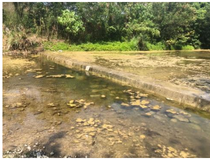
照片 3 固床工趾部積水
