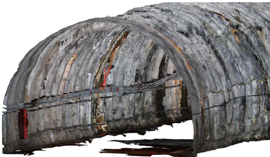
圖 3.6 案例隧道溪側側壁之兩條光纖(夾 62.53^\circ )
