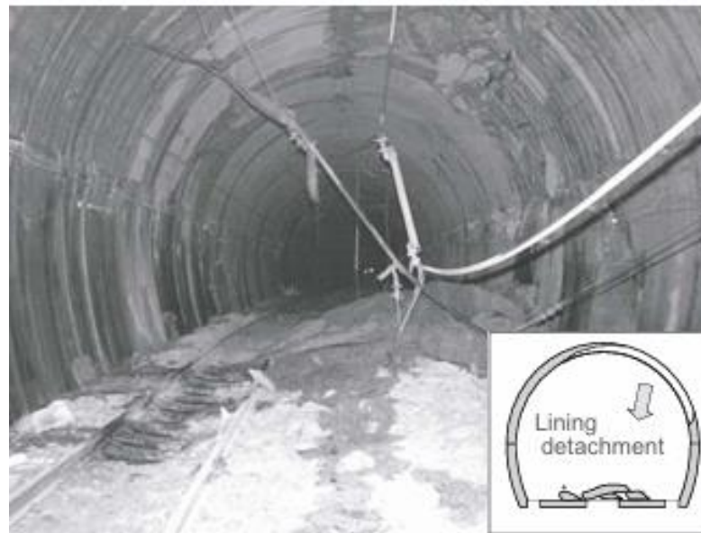
圖 2.7 Wanatsu 隧道損壞情形(Yashiro et al., 2007)
