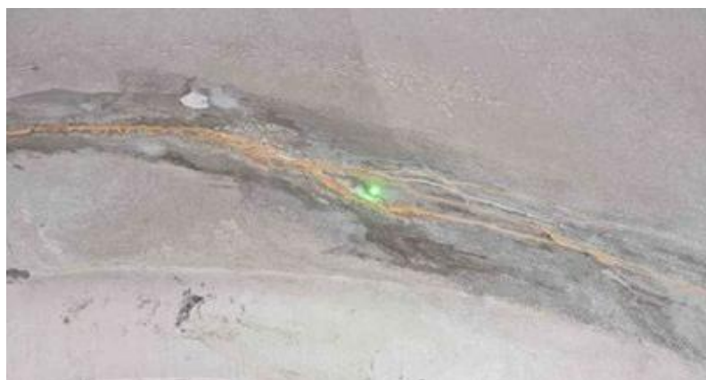
圖 2.2.7 營運中隧道襯砌裂縫
