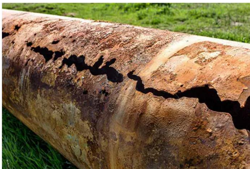
圖 2.16 受腐蝕磨損破壞的工業管線
