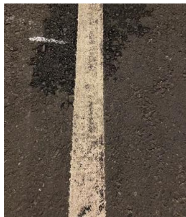
圖 4.3 標線表面因路口鄰近搶修工程施工受汙之結果
