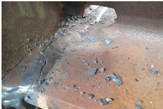
(c) 正 0.015 rad 南邊梁下翼板銲道破裂
