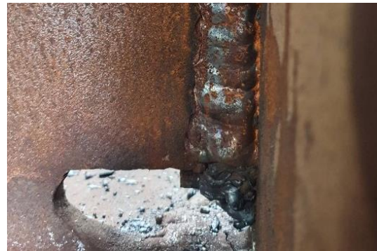
(d) 正 0.015 rad 南邊梁腹板銲道裂縫
