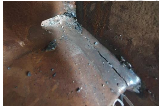
(b) 正 0.015 rad 南邊梁下翼板銲道破裂
