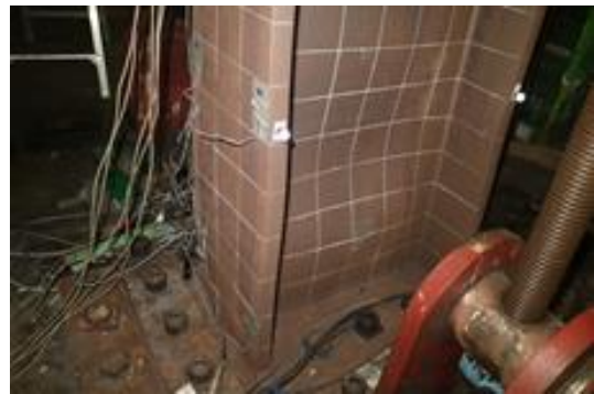
(d) 試驗結束柱底北側局部挫屈
