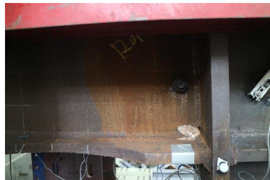
(d) 南側梁腹板局部挫屈
