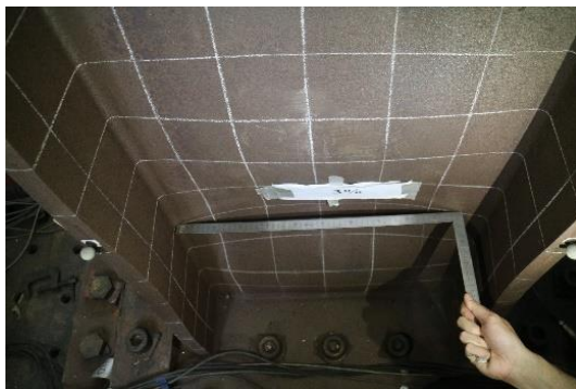
(c) 正 0.03 rad 柱底腹板局部挫屈
