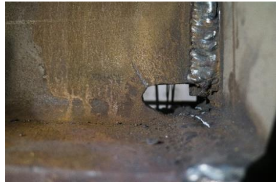
(h) 負 0.015 rad 南側梁銲道破裂
