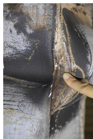
柱頂西面腹板 (裂縫)
