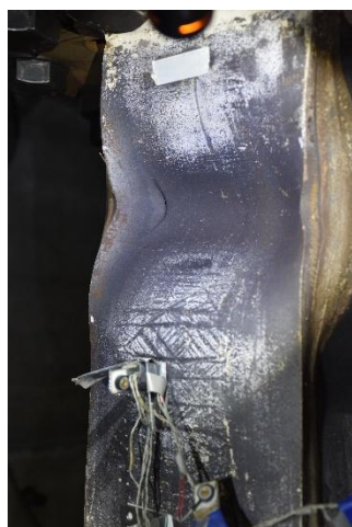
柱頂南面翼板 (裂縫)
