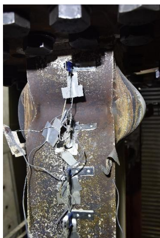
柱頂北面翼板 (裂縫)
