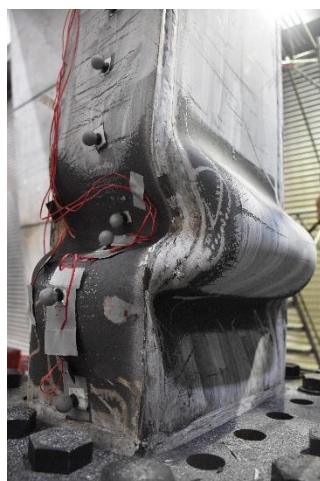
柱底西面腹板 (裂縫)
