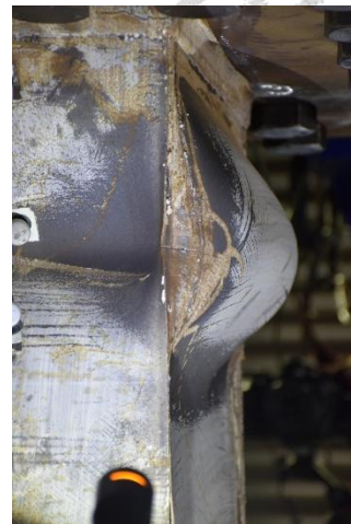
柱頂西面腹板 (裂縫)
