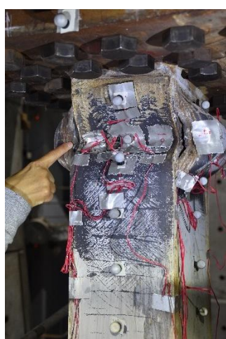
柱頂腹板裂縫
