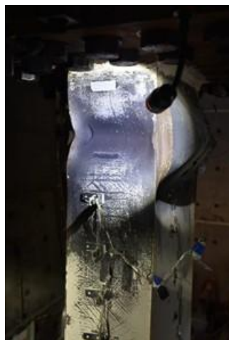
柱頂南面翼板 (裂縫)
