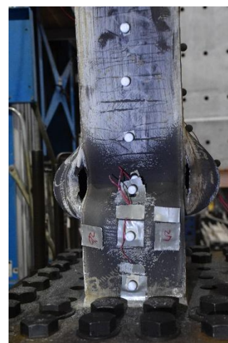
柱底東、西面腹板 (裂縫)
