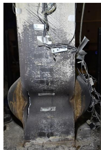
柱底南面翼板 (裂縫)
