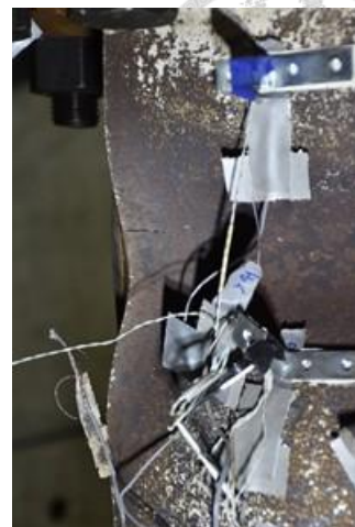
柱頂北面翼板 (裂縫)
