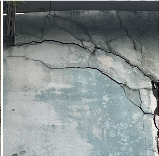
(b) 網狀裂縫 (攝於一壽橋)
