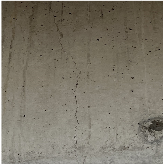
(a) 單一裂縫 (攝於福和橋)
