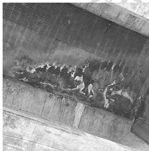
(b) 白華漏檢 (攝於永福橋)
