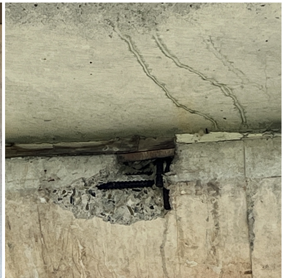
(d) 剝落伴隨鋼筋外露 (攝於一壽橋)
