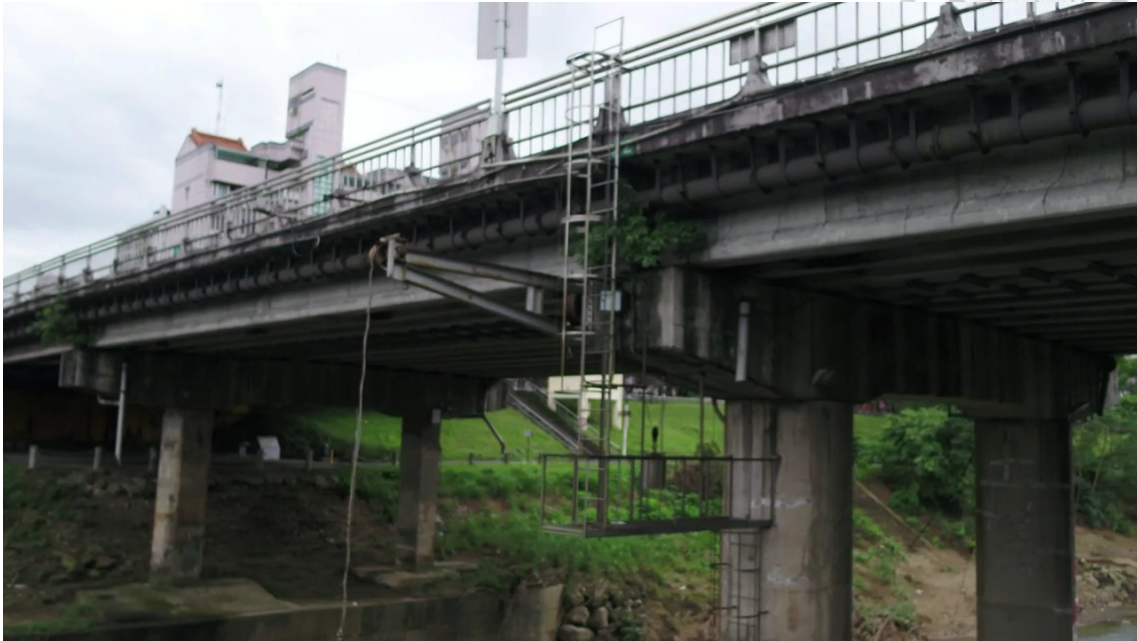
圖 4.12: 寶橋空拍畫面，橋下區域存在懸空電纜、鋼索等多項障礙物
