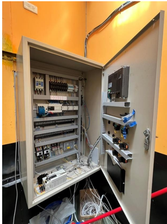
圖 3-6 PLC 系統內部
