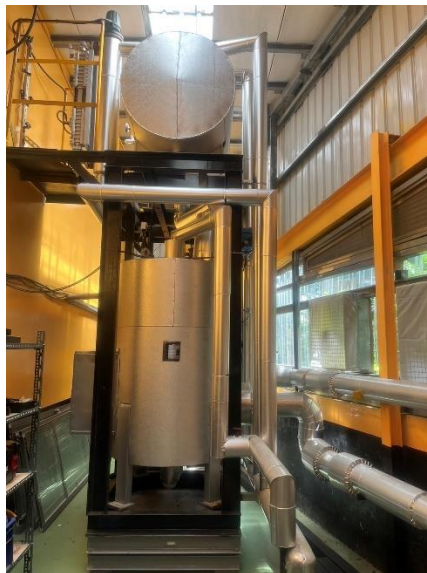
圖 3-1 直立電熱式蒸氣鍋爐(下)與臥式膨脹槽(上)實體圖
