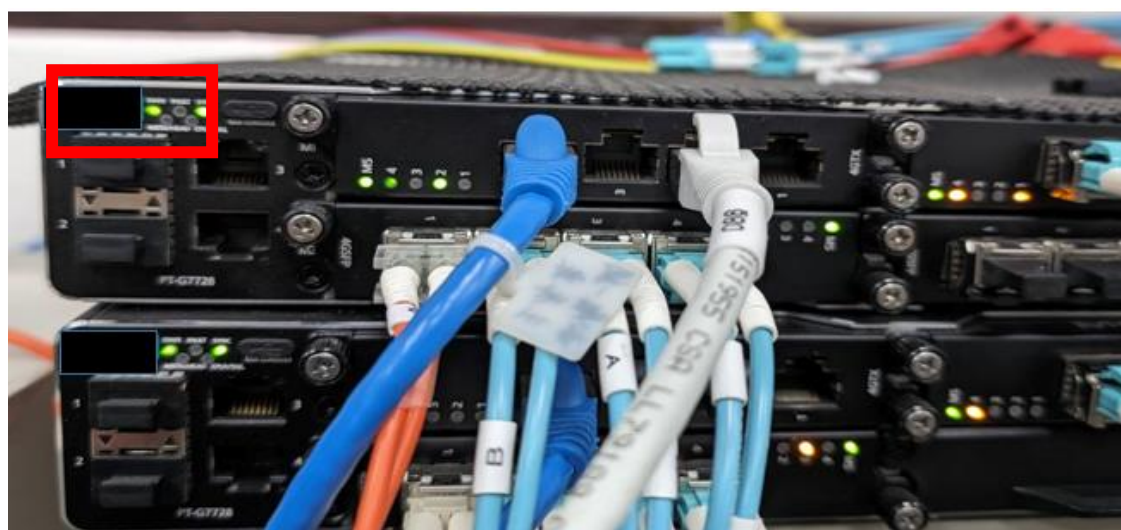
圖 32 本次實驗用 Switch 設備
