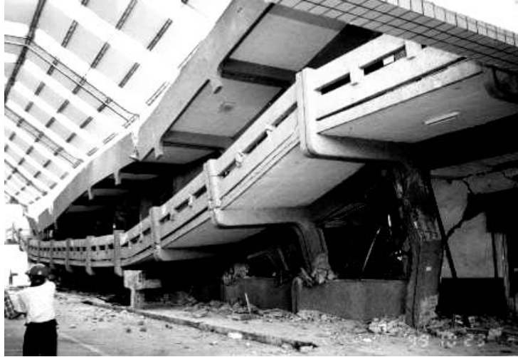
圖 2.6 懸臂走廊校舍損毀
