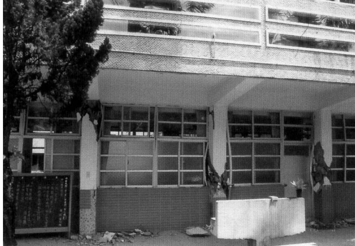
圖 2.4 學校建築沿長向之柱剪力破壞
