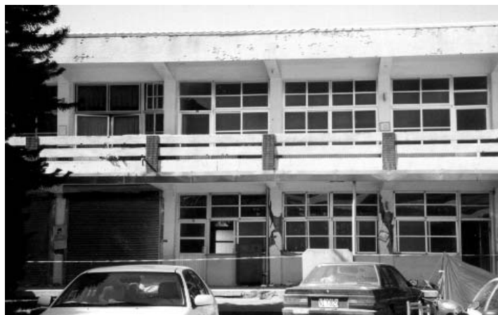
圖 2.3 學校建築沿長向柱發生剪力破壞
