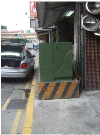
圖 5-3 人行道設置變電箱
