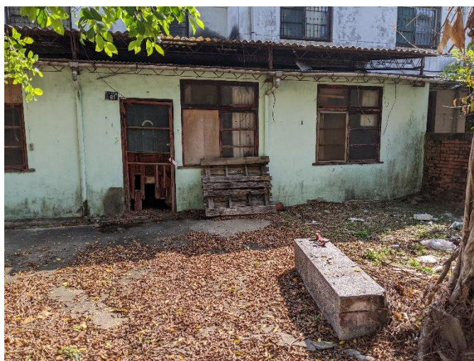
圖十四、閒置的宿舍。許多宿舍閒置多年，木門已經腐壞，底下的破口成為動物自由進出的通道。(圖片來源：賴櫻文拍攝)
