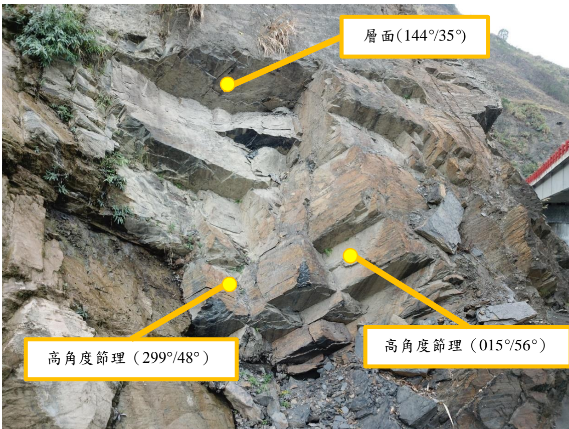
圖 4.12 荖濃溪案例之楔形破壞不連續面判釋，坡面位態：331°/74° (2019)
