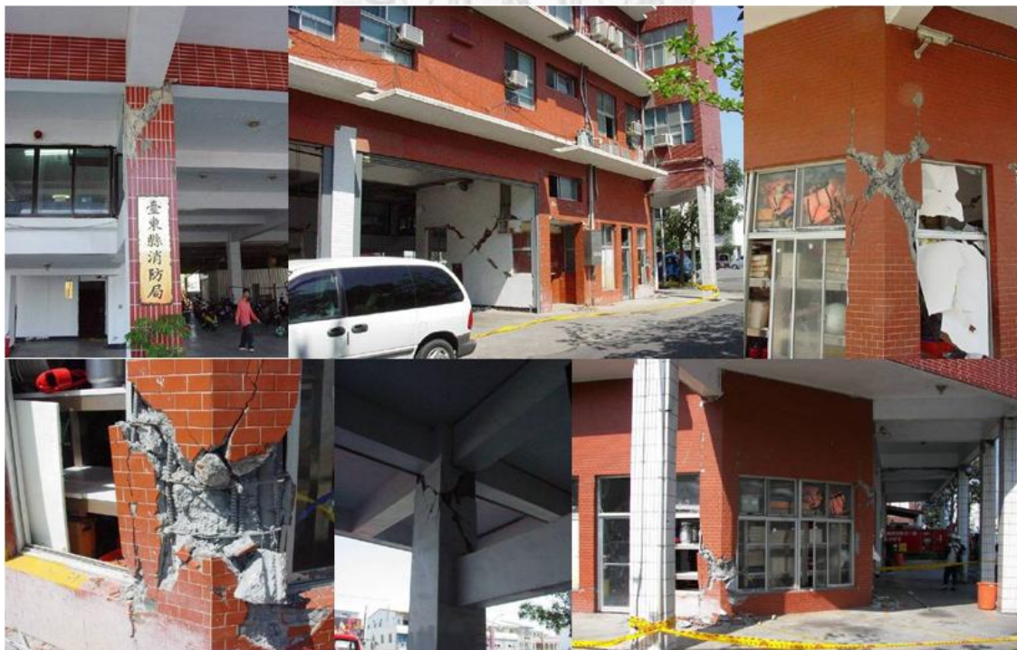
圖 4.4.5 臺東地震造成臺東縣消防局大樓受損情形[92]
