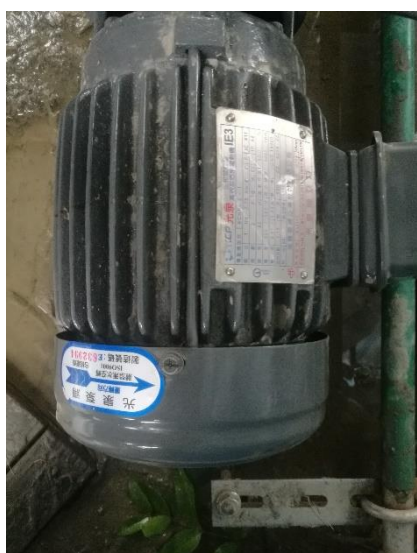
圖 3-8 熱水循環泵(HW-P)
