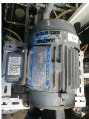
圖 3-10 淺層溫能循環水泵(SEC-P)
