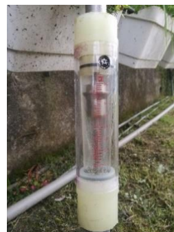
圖 3-17 冰水迴路、 地下水迴路流量計
