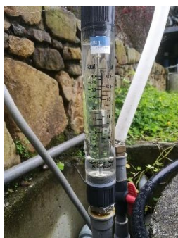
圖 3-16 淺層溫能循環迴路 流量計
