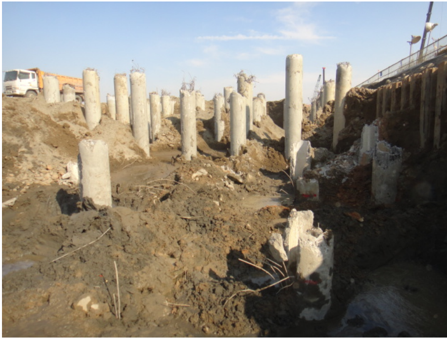
圖 3.1-6 PC 樁施工不良及斷樁圖
