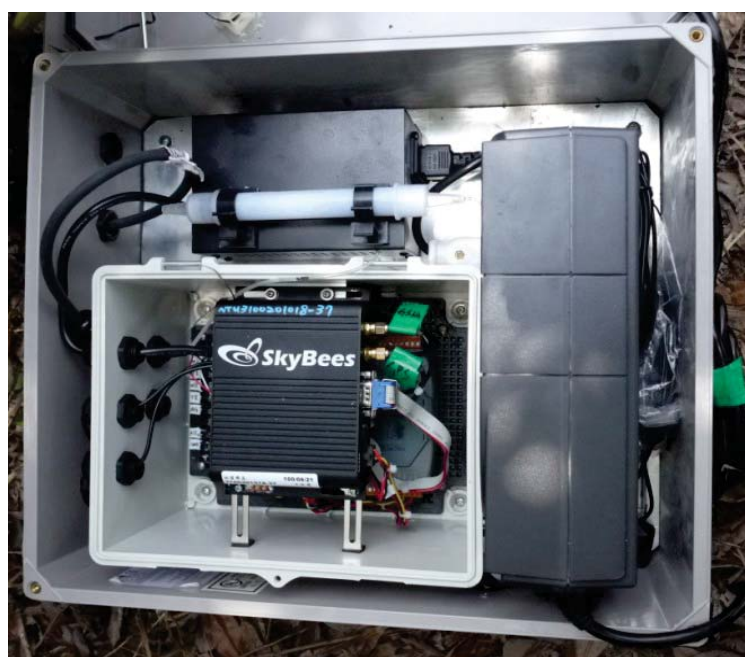
圖 4.8 社寮地下水位觀測井現地高頻遠端地下水位監測系統
