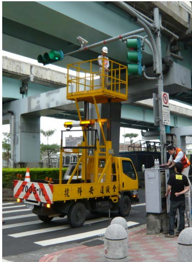
圖 3.4 攝影機現場架設情況
