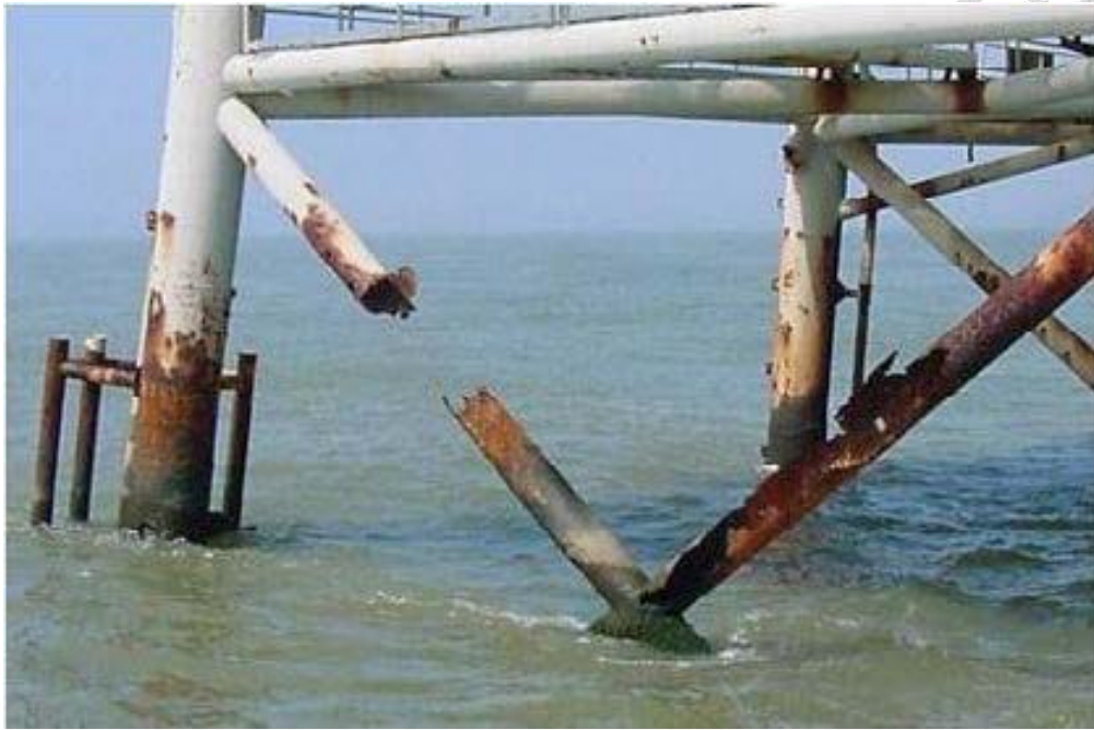
圖 1-3 處於飛沫帶之海上結構腐蝕情況[16]
