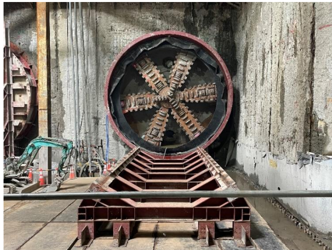
圖 2.8 TBM 切削頭(攝自桃園捷運綠線)
