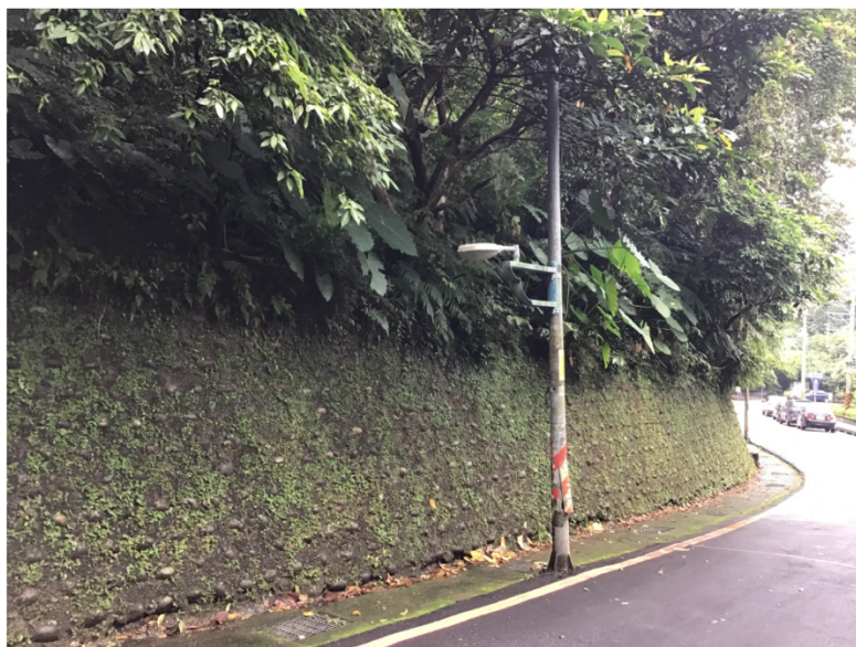
圖 47、工程改善前，漿砌卵石擋土牆阻礙動物通行
