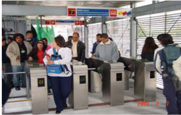
圖 3.2-59 波哥大 BRT 系統收費閘門
