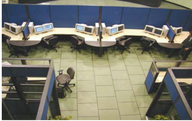
圖 3.2-58 波哥大 BRT 中央行控中心監控室
