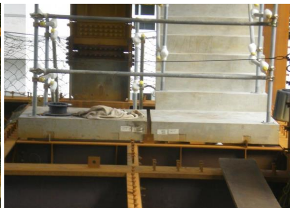
預鑄樓梯樓板安全護欄
