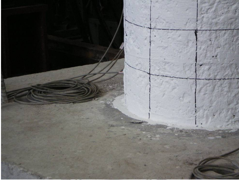
圖 4.5 試體 B 擬動態試驗後之北側柱底照片 (TCU102 真實地震力, 100 gal)
