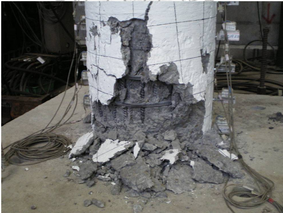
圖 4.10 試體 B 擬動態試驗後之北側柱底照片 (TCU102 真實地震力, 326gal)
