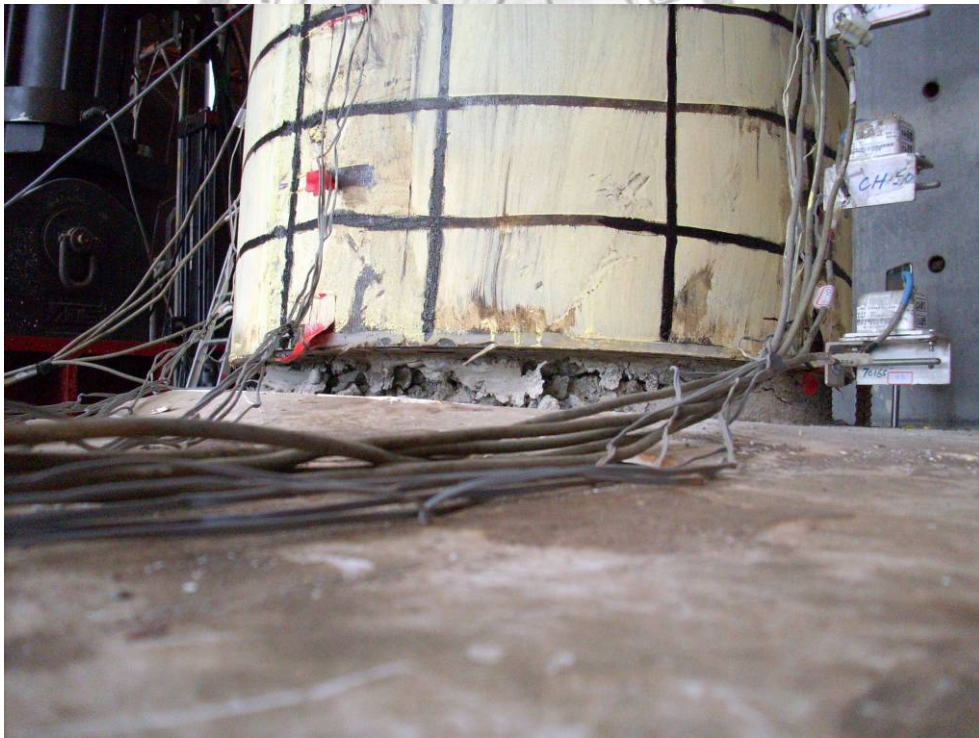
圖 4.45 試體 D 反覆試驗後之北側柱底照片
