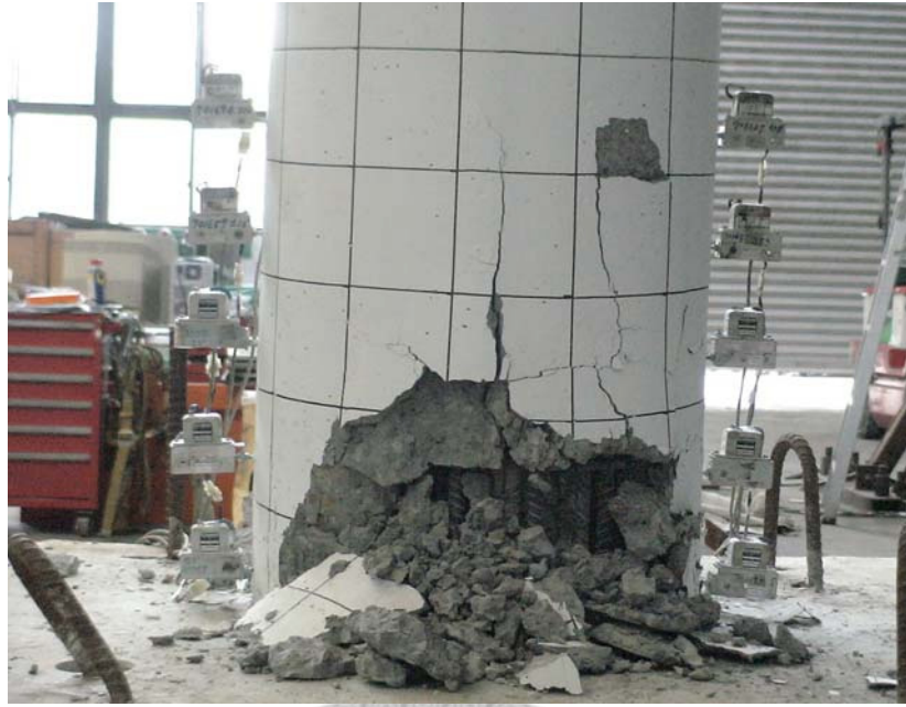
圖 4.19 試體 C 反覆載重試驗 (5%側移率) 後柱底照片
