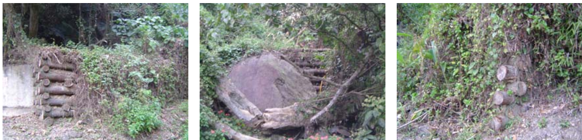
圖 A.11 工程 M，在台 16 線上，共 3 座擋土牆，下 3 圖分別是 3 座擋土牆之照片
