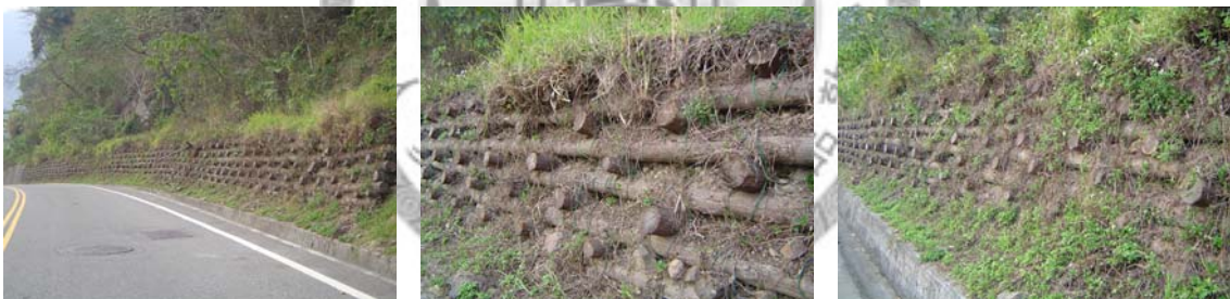
圖 A.14 工程 P，上方植生茂密，側邊較少。但側方少部分區域植物生長佳
