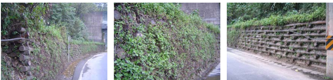
圖 A.15 工程 Q。與隧道相接，有積水。 植物生長茂盛，但靠近隧道處側邊植生較少
