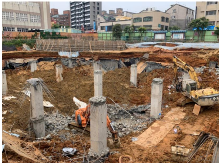
圖 1.2 桃園市平鎮區地下停車場工程之無梁版貫穿破壞照片
