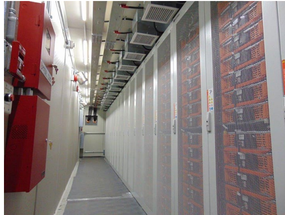
圖 2-24 美國杜克能源的 2 MW 儲能系統 (Larson A., 2015).
