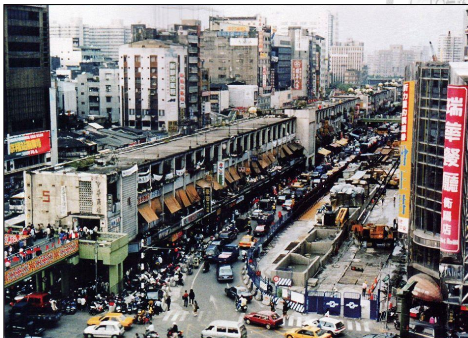
圖 2-12 1992 年 10 月即將進行拆除的中華商場與同時捷運施工的中華路
