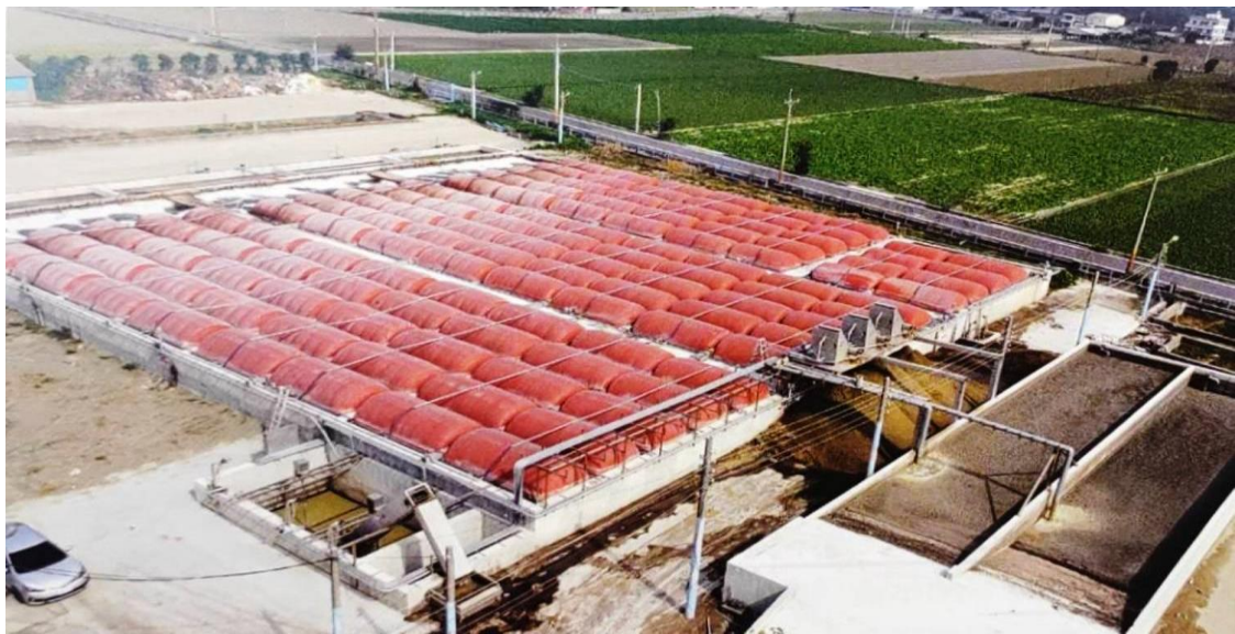
圖 3-2-4 傳統紅泥沼袋厭氧發酵槽及氣曝池
