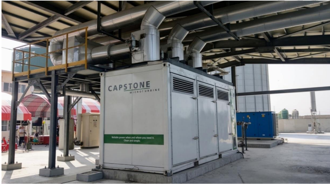
圖 3-2-9 美製沼氣發電機，環保署「大帶小」集中處理場
