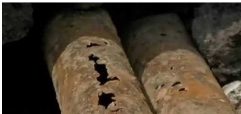
圖 2-4 高雄地下管線氣爆圖[24]
