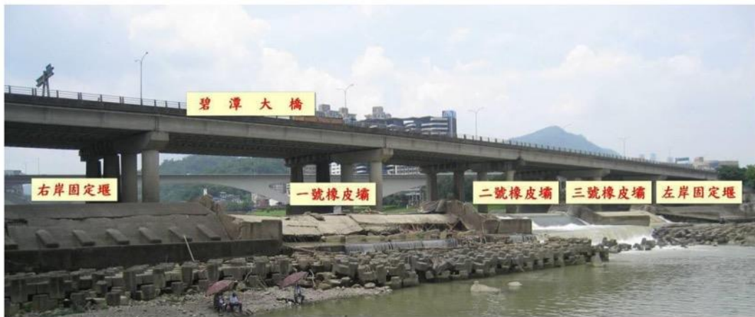
圖 36 蘇迪勒風災後碧潭堰受損情況（2015）
