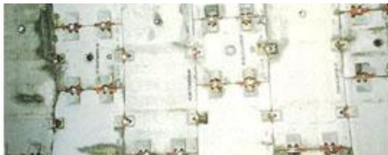
圖 2.6 潛盾隧道內之滲水情況(松本嘉司，1994)
