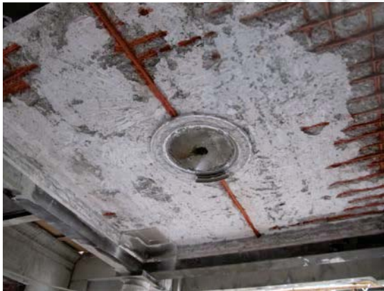
（圖 3-29）過水廊頂上的電燈，線條處為鋼筋外露處。（筆者自攝，2012.6）
