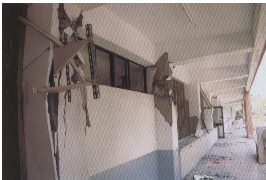
圖 1-2 短柱之剪力破壞(氣窗)
