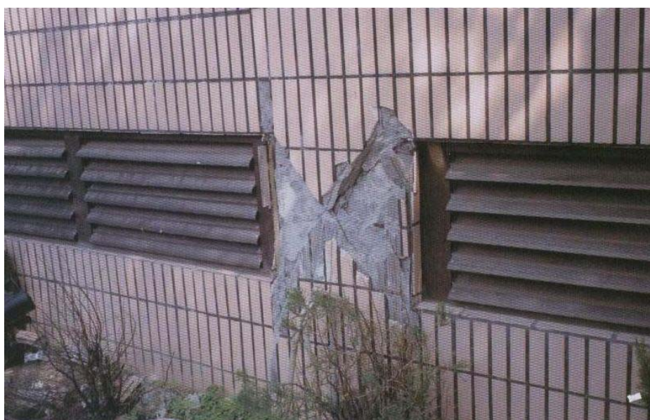
圖 1-1 短柱之剪力破壞(通風孔)
