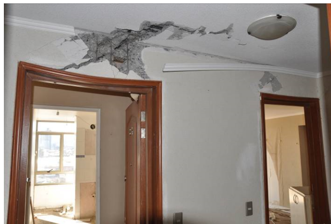
圖 1-1 RC 牆大量開窗與開門造成明顯剪力破壞
