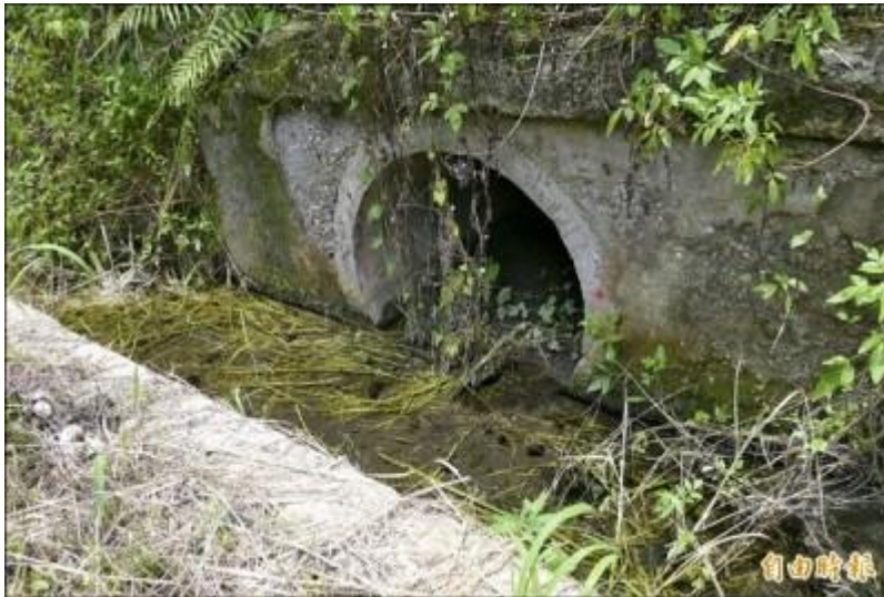
圖 3.1.10 老舊排水箱涵
