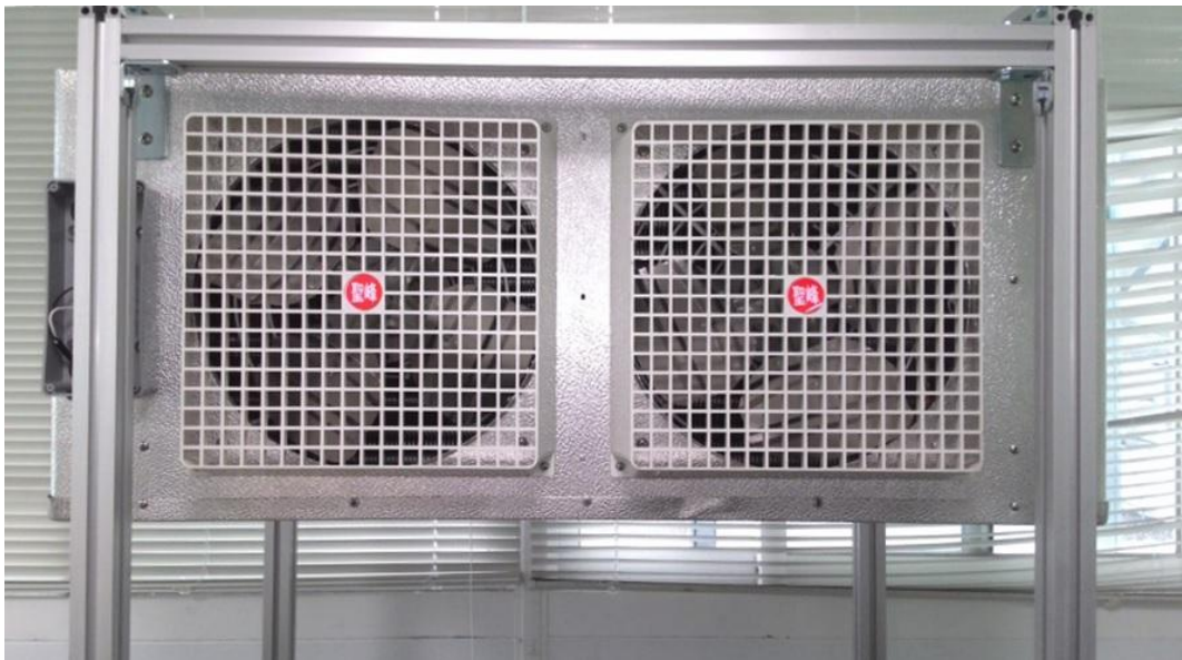
圖 4.1.11 變頻空調系統-室內機組
