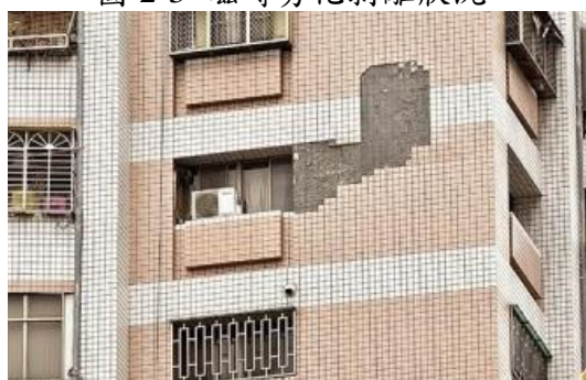
圖 2-5 磁磚劣化剝落狀況
