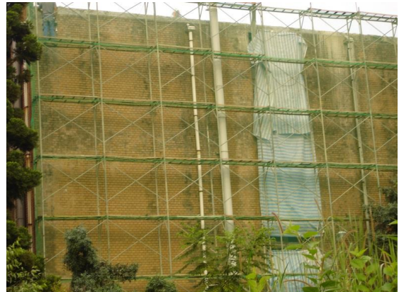
圖 1-4 臺灣大學森林館，外牆 13 溝面磚嚴重剝落，恐危及師生安全（2015）
