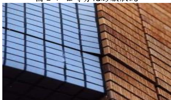
圖 2-6 磁磚劣化隆起狀況
