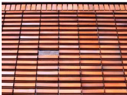
圖 2-3 磁磚劣化剝離狀況
