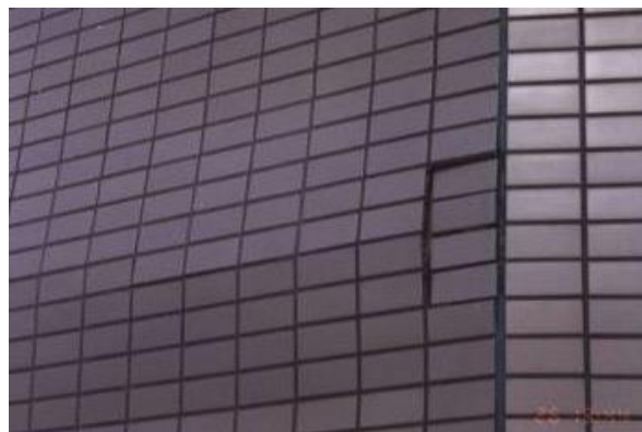
圖 2-4 磁磚劣化膨脹狀況
