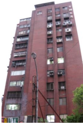
圖 2-7 磁磚劣化拔華狀況
