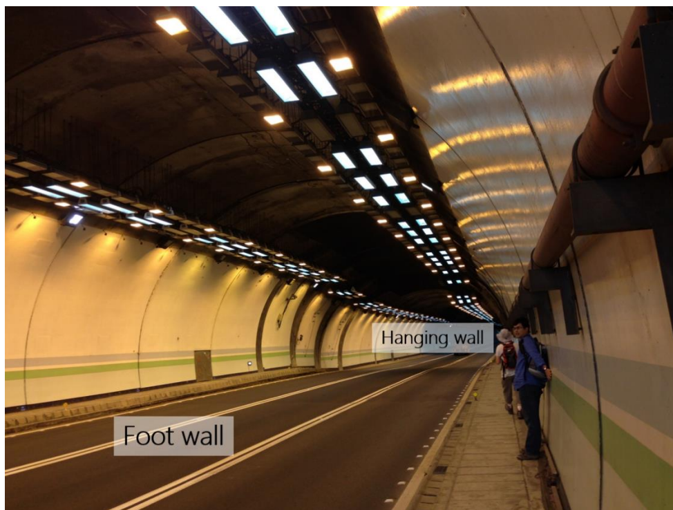
圖 2-8 中寮隧道因旗山斷層潛變造成之變形，可見旗山斷層上盤(西北方)相對下盤(東南方)為相對陷落，此運動方向不同於逆衝斷層錯移方向。
