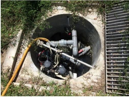
a、供水泵浦
