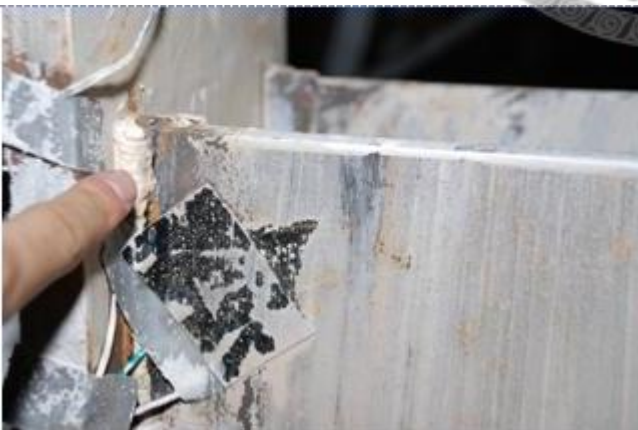
(e) 試體五下端接合板與柱焊道開裂(背面)(-0.025 rad)
