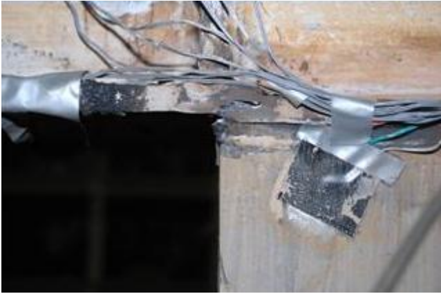
(a) 試體五上端接合板沿梁翼板開裂(背面)(-0.02 rad)
