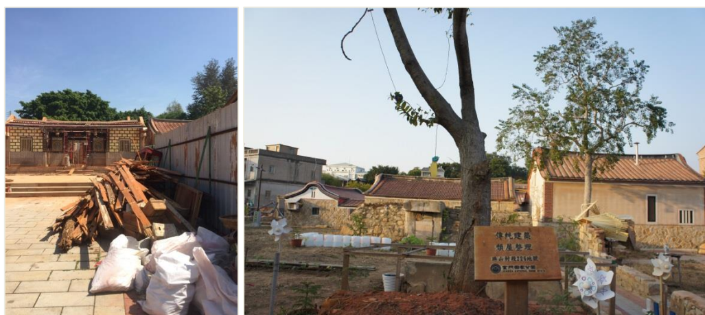
圖 13 古厝破落及修繕現況
