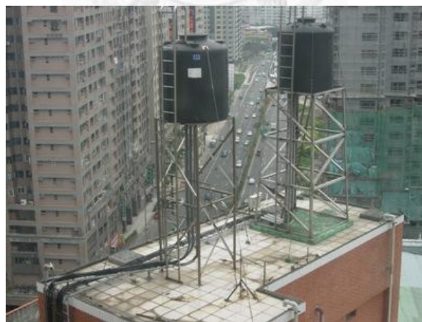
圖 8 基地台偽裝成水塔
