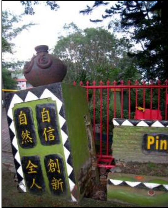
(左圖) 泰武國小受地層滑動影響，校門前寫著學校願景「自然、全人、自信、創新」的柱子，嚴重傾斜。(攝影／林巧璉)
